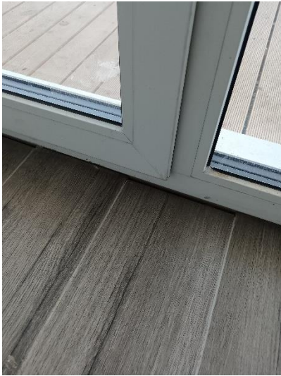
Фото: щели между напольной плиткой и оконным блоком
