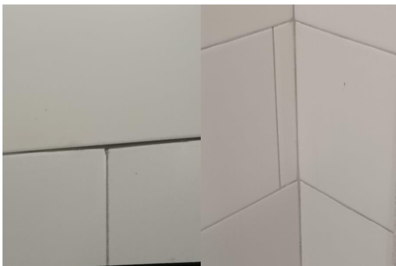
Фото: некачественно выполнена затирка и укладка плитки
